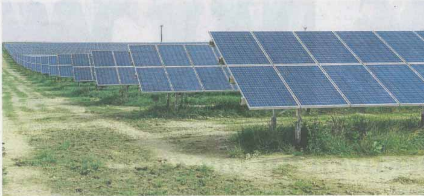
Mit der Photovoltaikanlage erfüllt die Gemeinde Vierkirchen ihre ökologischen Hausaufgaben.
